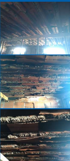
Plafond de l'appartement avec éclatement des marmites
